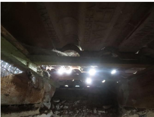
Abb. 5: Gebäude auf Flurstück Nr. 153/13, frei liegende Dachziegel mit Spalten
